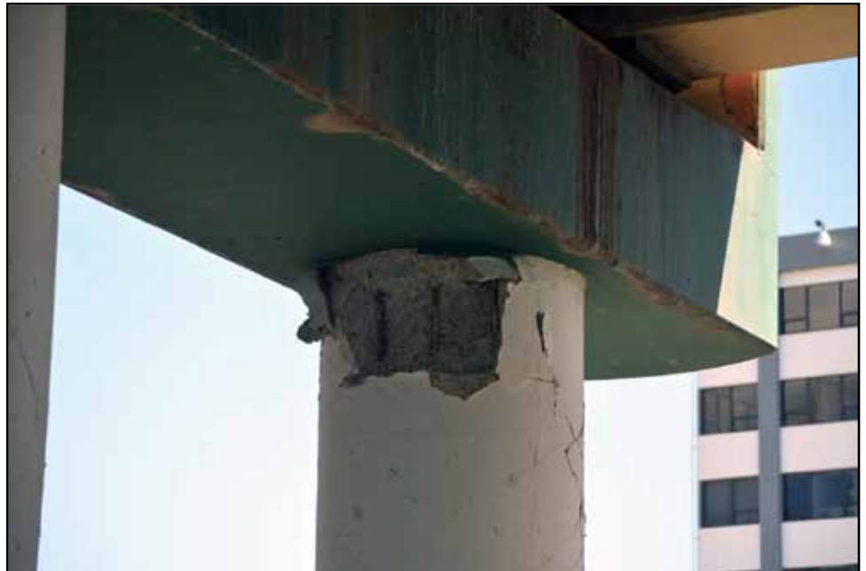
Daños a columna más nueva.
